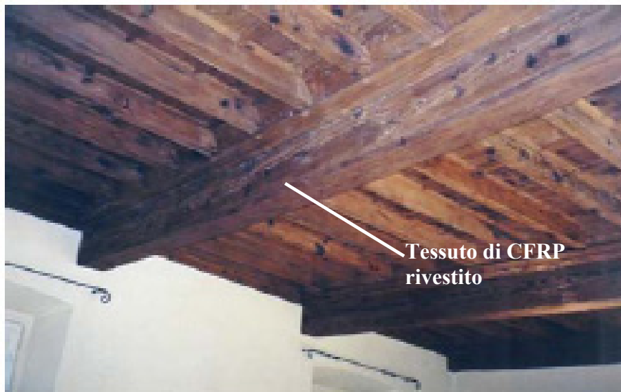
Figura 9-5 –Intervento di rinforzo eseguito sulla trave principale (progettista: ing. G. Ussia – Ardea Progetti e sistemi S.r.l.).
