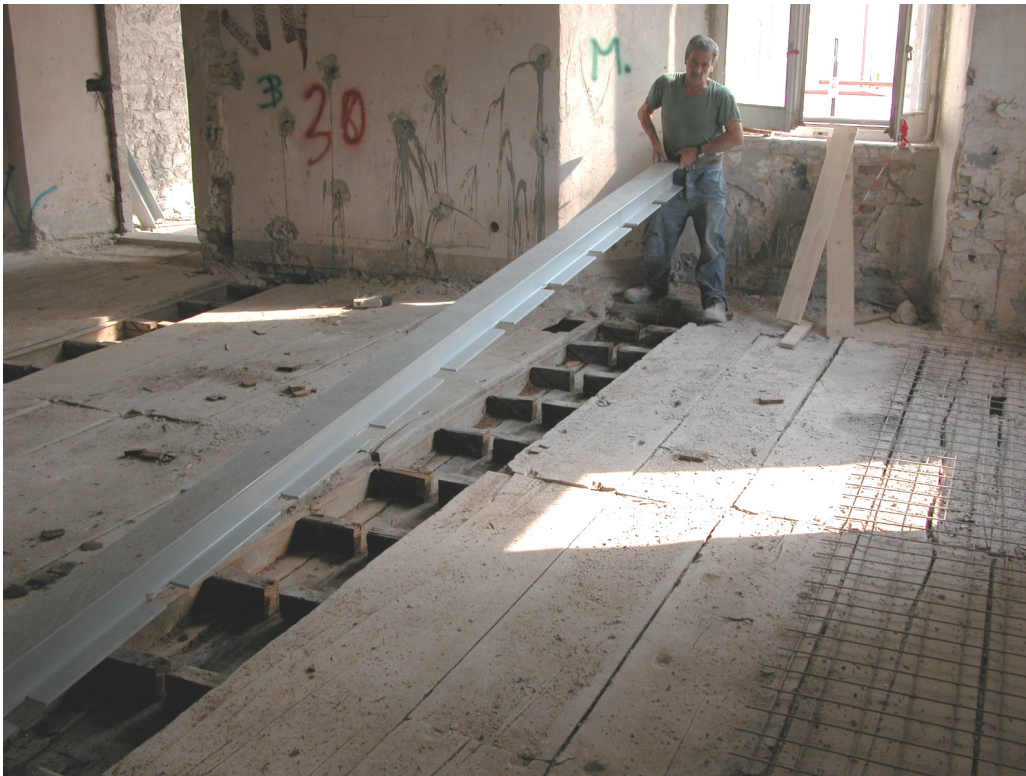
Figura 9-4 –Intervento di rinforzo eseguito sulle travi principali (progettisti: ingg. A. Giannantoni e F. Menghini, in collaborazione con il prof. A. Borri).
