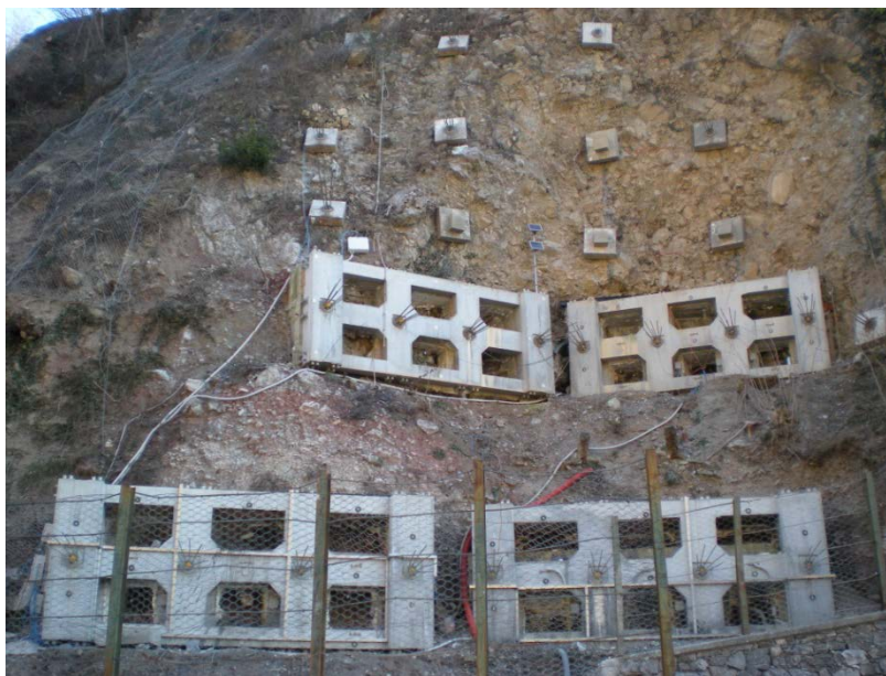
Figura 1-6 – Caslino d’Erba (CO), Italia, (2008) Graticci e piastre di ancoraggio realizzate in calcestruzzo autocompattante fibrorinforzato per la stabilizzazione attiva di pendii. Calcestruzzo C60–S5–12–XC4–F4–DH1–DS1 (UNI11039).
