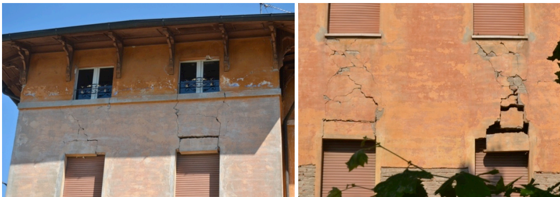
Fig. B-2 Danno nelle fasce di piano, con attivazione di meccanismi sia di pressoflessione che taglio.
