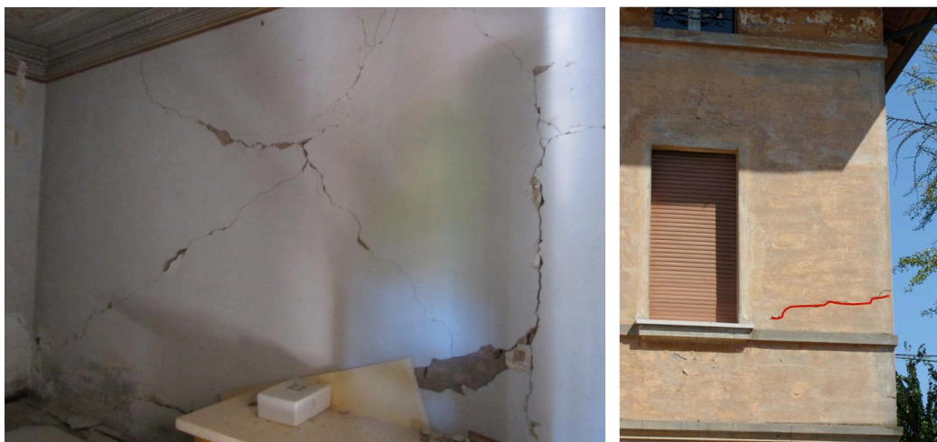
(a) (b) Fig. B-3 Lesioni nei maschi: (a) rottura a taglio in una parete interna; (b) pressoflessione in un maschio poco caricato al secondo piano di una parete perimetrale.
