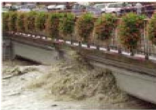
Figura 7.1: Franco idraulico insufficiente
