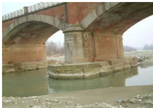
Figura 7.3: Scalzamento al piede delle pile
